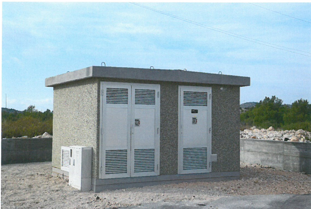
Trafostanica s ormarićem za javnu rasvjetu
